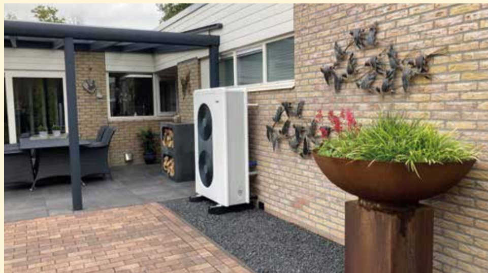
De buitenunit van de warmtepomp is het enige direct zichtbare element van alle verduurzamingsmaatregelen die de bungalow heeft ondergaan.
