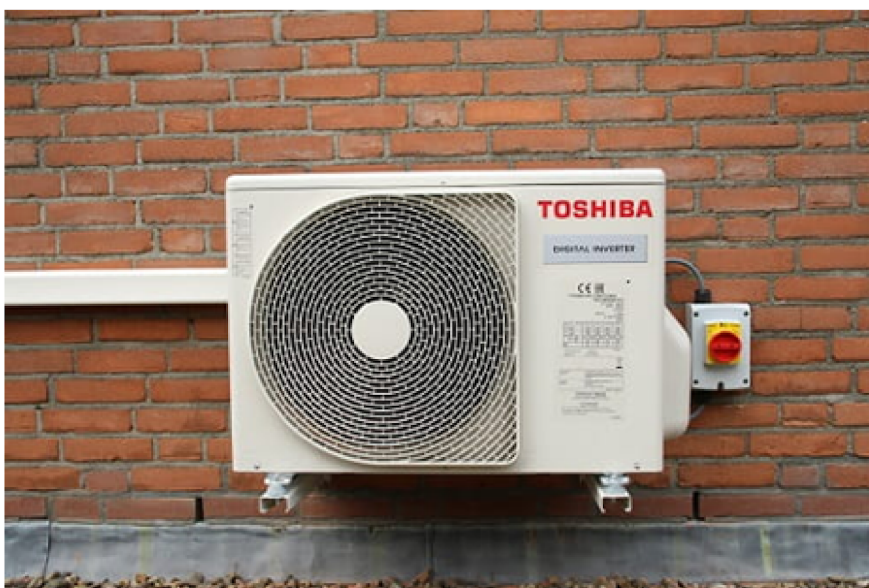
De buiten-unit van een hybride warmtepomp.
